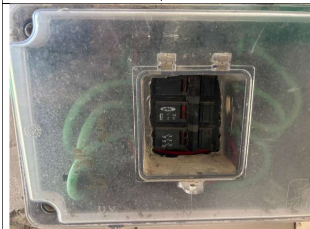
FOTO 11: Instalação elétrica existente;
